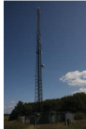
Gittermast med flere udbydere
