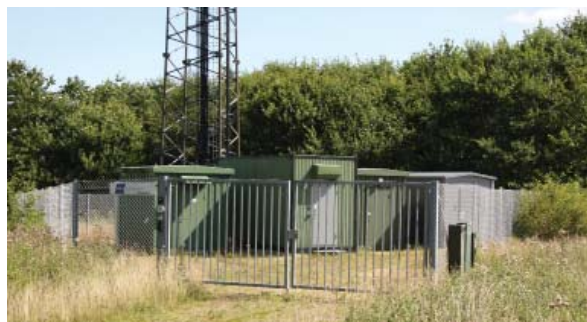
Samling af teknik-huse fra flere operatører ved gittermast i erhvervsområde ved Herning
